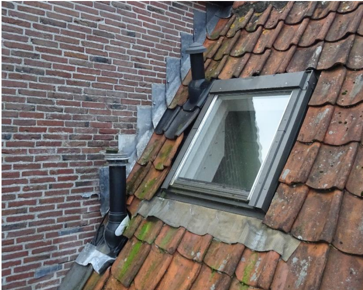
Openingen onder dakpannen naast raam
