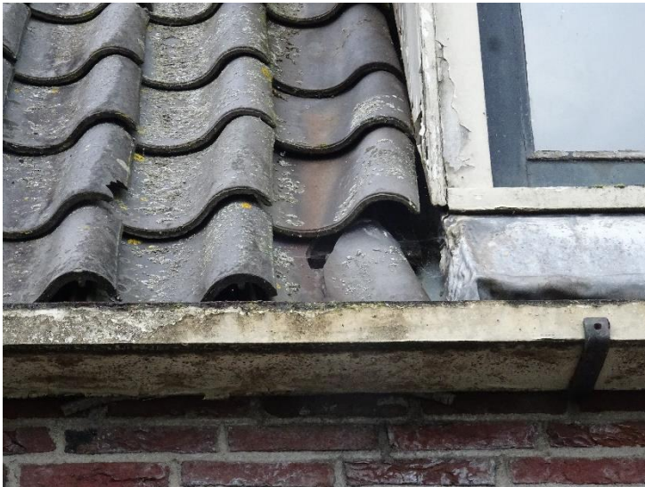
Openingen onder dakpannen
