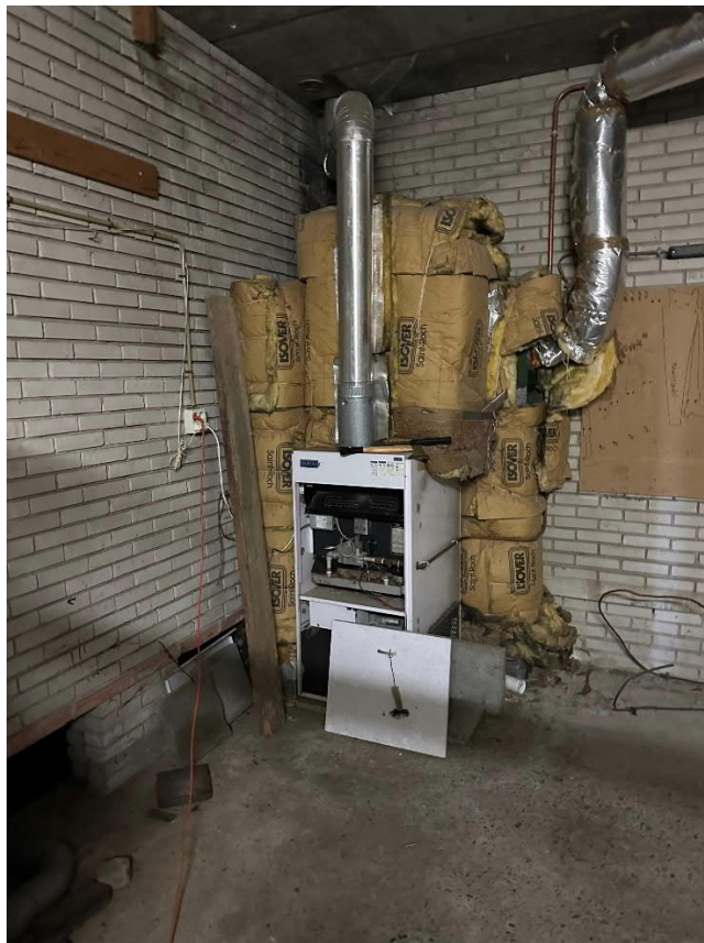
centrale verwarmingsruimte annex garage hoofdwoning
