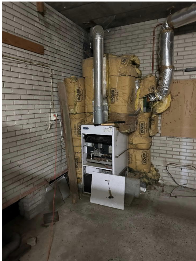
centrale verwarmingsruimte annex garage hoofdwoning
