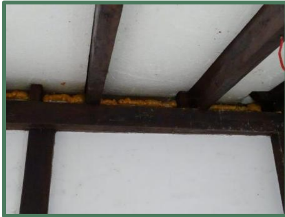
Oud bouschuim tussen de wand en het dak van de opslag
