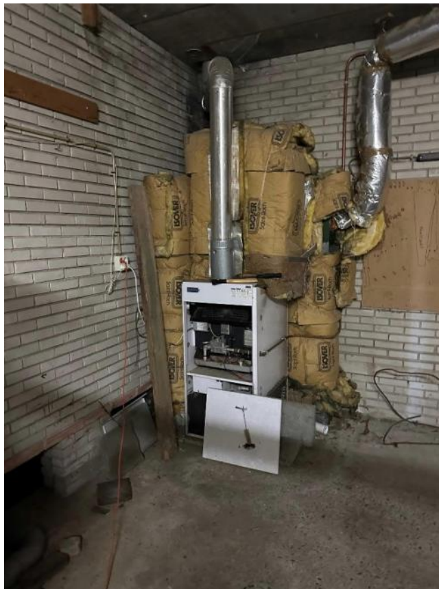
centrale verwarmingsruimte annex garage hoofdwoning
